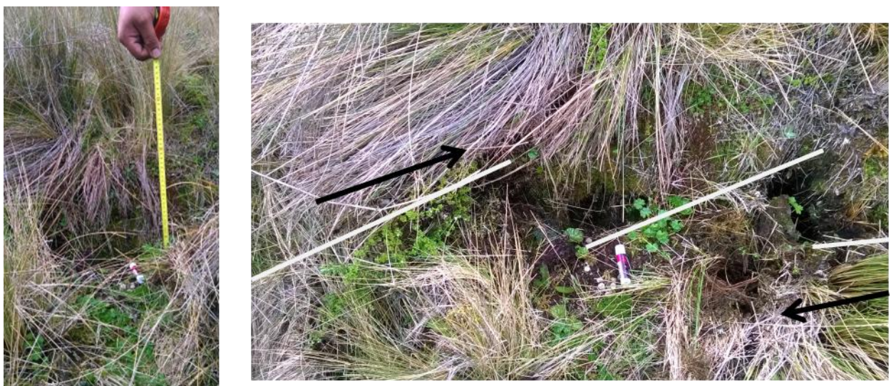
Figure 32 : Indices de rupture de surface dans la partie sud de la faille, avec la composante verticale à gauche et la composante horizontale à droite (fractures en échelon)
