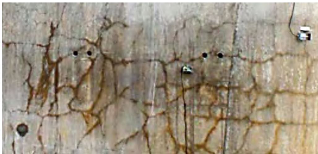
Figure 1. Béton dégradé par la RSI
