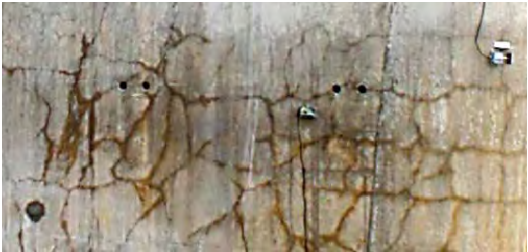
Figure 1. Béton dégradé par la RSI
