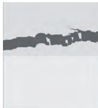
Figure 2 : Ouverture de fissures du béton en traction
