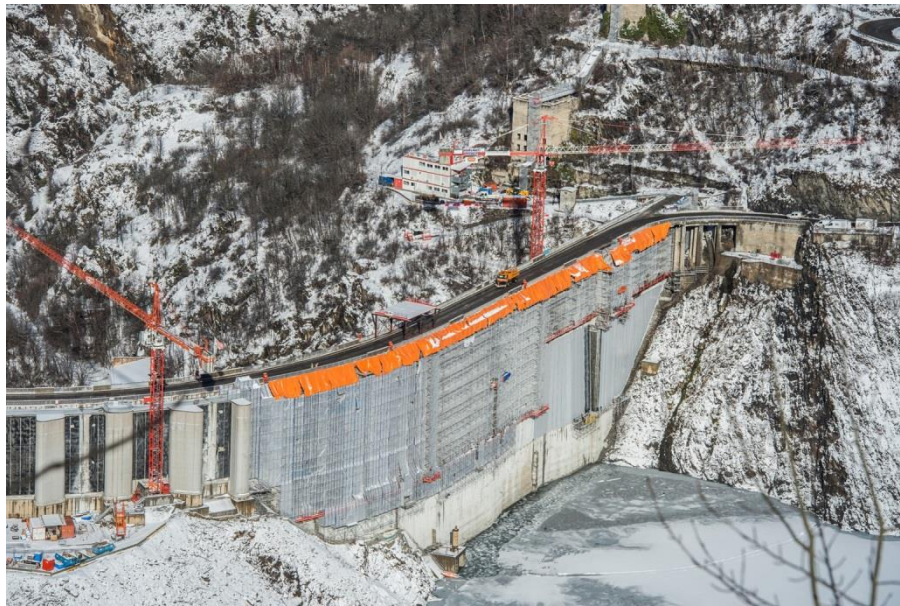
Figure 1 : Barrage du Chambon lors des travaux de pose de la géo membrane en PVC après sciage du corps du barrage ( http://www.carpitech.com ).
